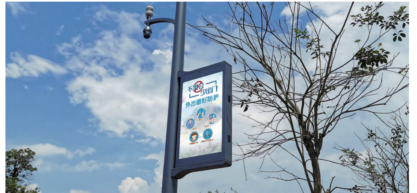
佛山三龙湾大道智慧灯杆屏项目
