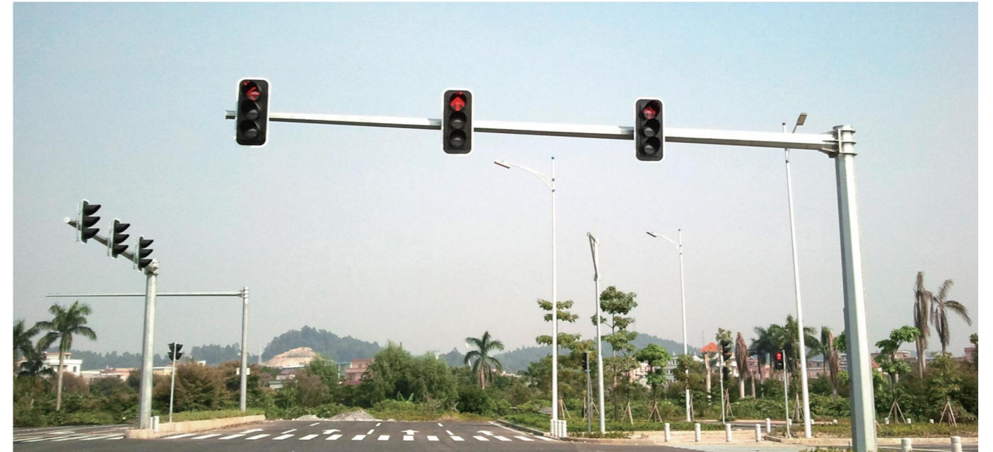
东莞常平镇智慧交通项目
