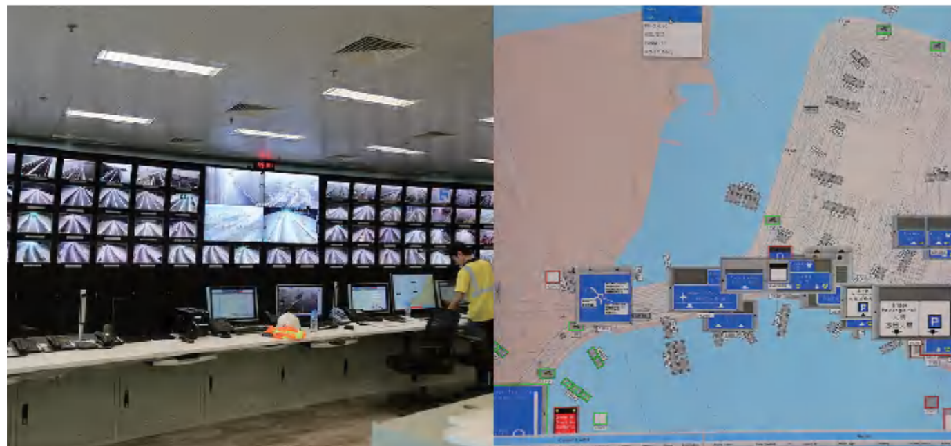
港珠澳大桥监控系统项目
